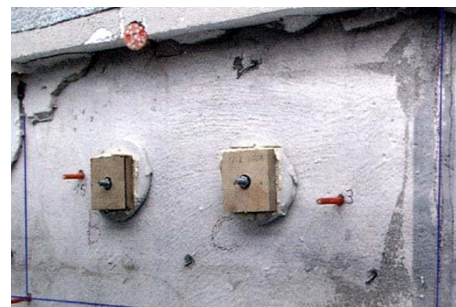
Фото 2. Отказ WDVS с комбинированным креплением. Полевой контроль прочности сцепления с основанием и дюбельного крепления непосредственно на объекте[28].
