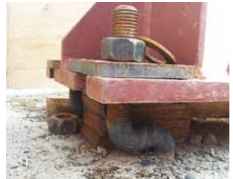
Рис. 3. Брак монтажа при креплении колонны вследствие смещения закладной детали
