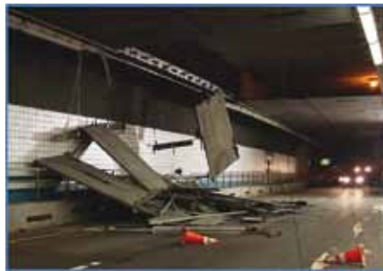
Рис. 1 Обрушение подвесных плит в тоннеле в Бостоне, США, 2006 г.
